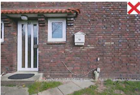
Das Anbringen jeglicher sichtbaren Leitungsführung an der Gebäudehülle ist unzulässig
