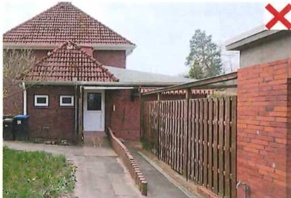
Sichtschutz zwischen Wohnhaus und Nebengebäude überschreitet die maximal zulässige Länge von maximal 50%
