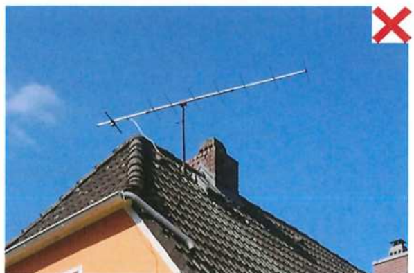
Das Anbringen von Dachantennen auf dem Dach des Gebäudes ist unzulässig
