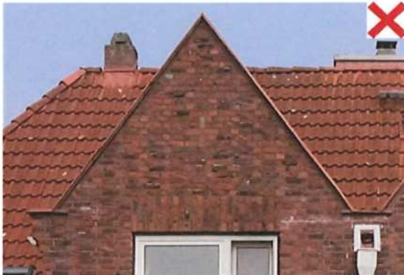
Giebelkreuz im Zwerchhausgiebel verfüllt und somit nicht mehr ablesbar
