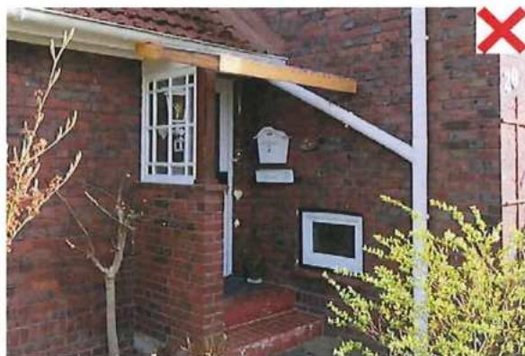
Windfang - und Vordachkonstruktion in dieser Art unzulässig und nicht denkmalverträglich
