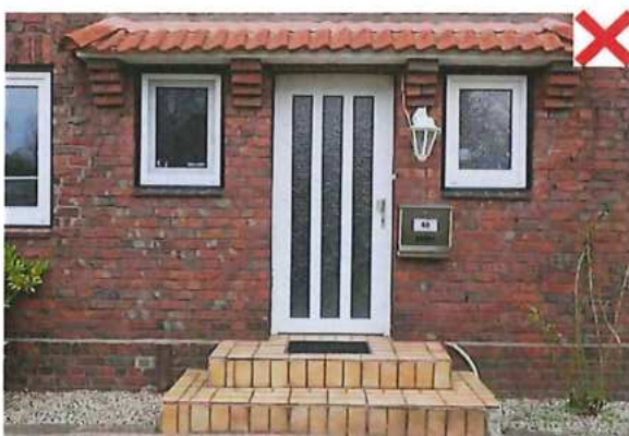
Verkleidetes Eingangspodest mit unzulässigem Material
