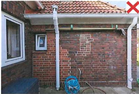
Der verwendete Stein wurde nicht an das Bestandsgebäude angepasst und die Öffnung wurde verzahnt zugemauert
